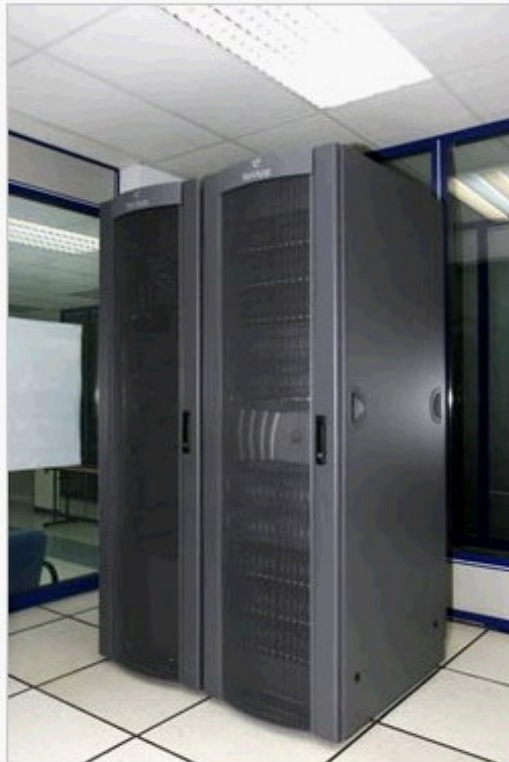
Con la cabina NetApp FAS3170, CESCA ha pasado de 16,5 TB a 61,7 TB de almacenamiento
